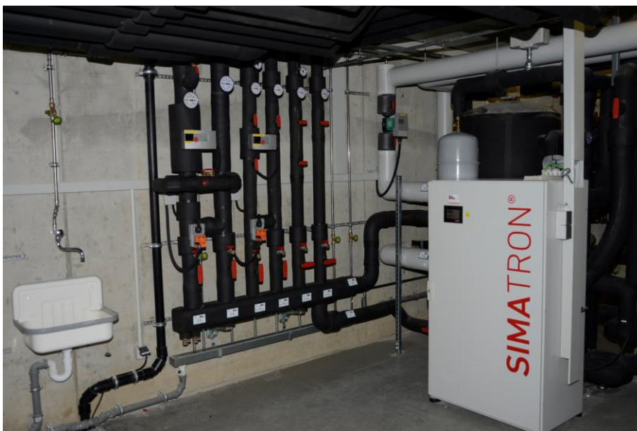
Abbildung 95: Wärmepumpe zur Versorgung des Gebäudes mit Kälte und Wärme 75
