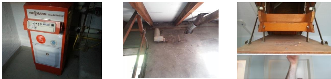
Abbildung 101: Energetische Einblicke: Heizung Baujahr 1995, ungedämmtes Dachgeschoss, ungedämmte Bodentreppe
