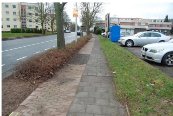
Bauliche Mängel und überholte bauliche Trennung des Fußwegs entlang der Straße Reimerdeskamp
