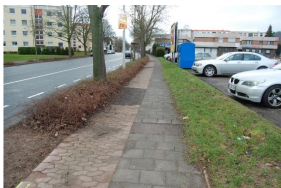
Reimerdeskamp: Veralteter Belag mit baulichen Mängeln
