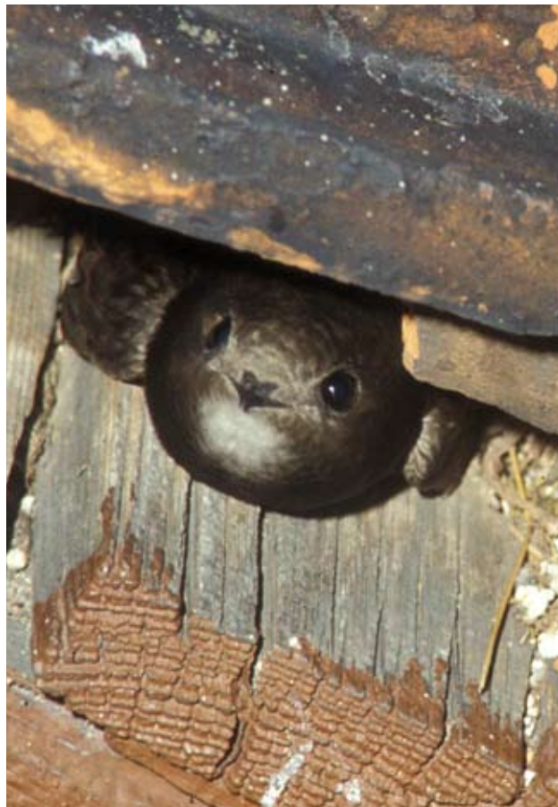
Mauersegler unter Dachziegel
