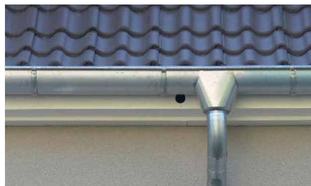
Dachkästen mit Einflugloch
