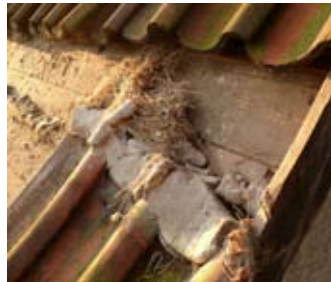
Nistmaterial unter Dachziegeln
