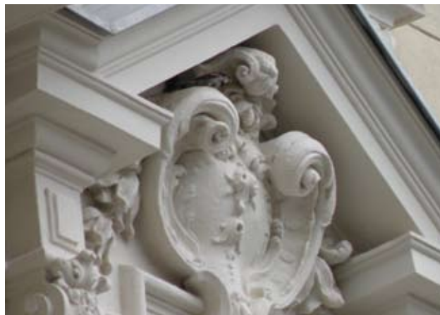
Spatzennest hinter saniertem Stuckelement
