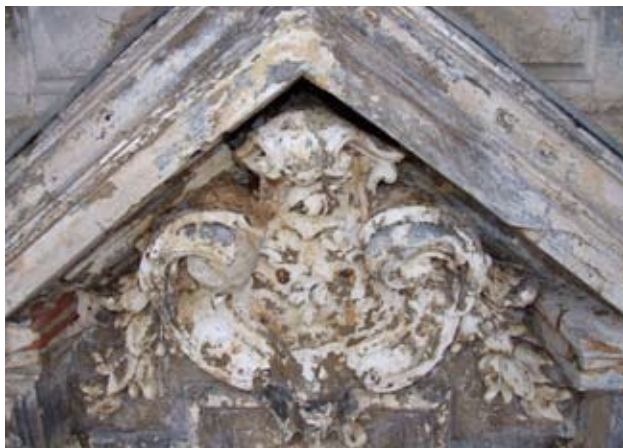
Spatzennest hinter Stuckelement vor der Sanierung
